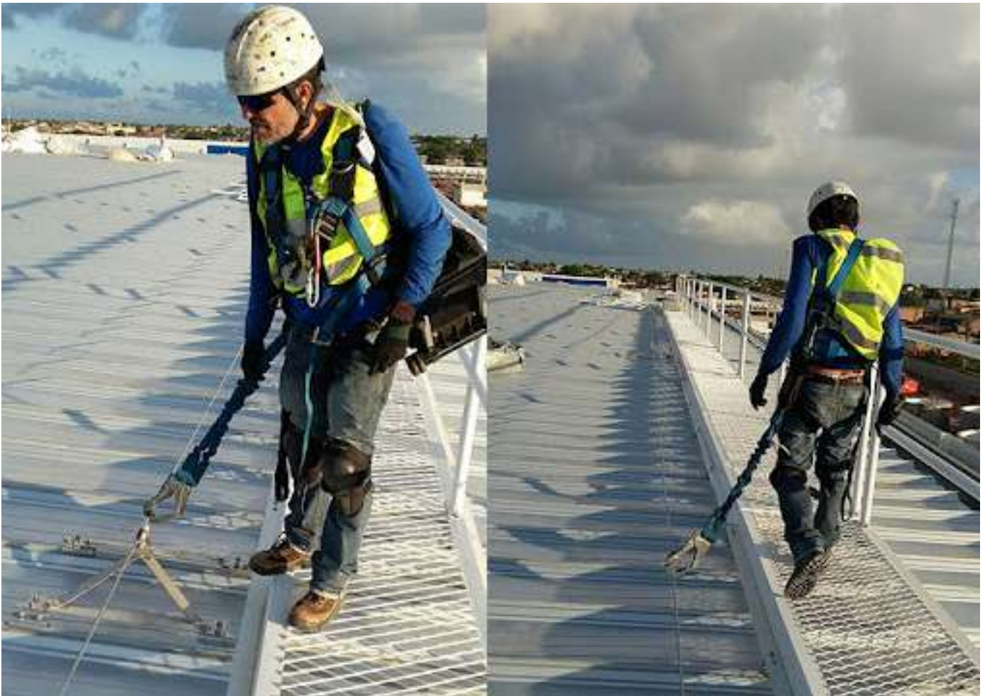
Profissional utiliza a linha de vida enquanto caminha por cima de uma passarela em telhado. Foto: MIL Soluções/Reprodução
