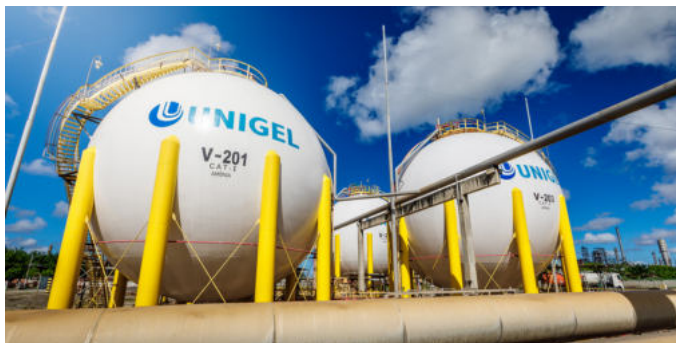
Tanques de amônia na fábrica da Unigel. Foto: Unigel/Divulgação
