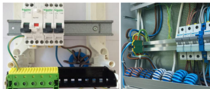
Figura 10 - Anéis de ferrite instalados nos condutores de fase dos circuitos dos microinversores em instalações monofásica (à esquerda) e trifásica (à direita). Fonte: [1]
