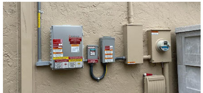
Instalação residencial em uma casa na Flórida, EUA. Foto: PES Solar/Divulgação
