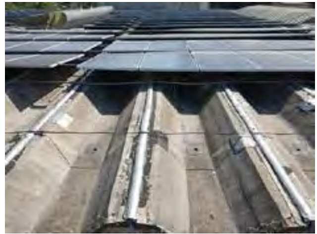
Problemas de fixação e no acabamento do sistemas FV instalado. Foto: Azzon Energia
