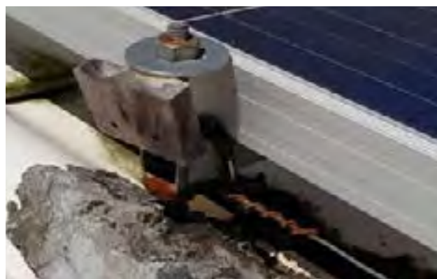
Fixação dos módulos FV foi apenas um dos problemas encontrados na residência atendida por Glenio Foto: AG4 Engenharia
