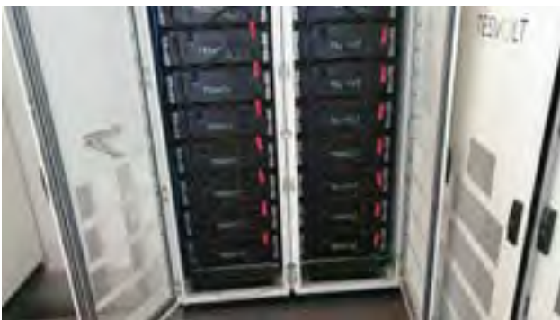
Banco de baterias da Tesvolt de 300 kWh. Foto: Canal Solar
