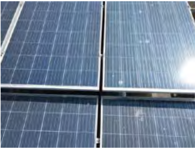
Instalações erradas, gerando sombras nos módulos FV. Foto: Azzon Energia
