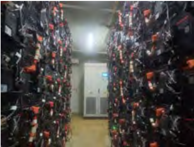
Banco de baterias de 1.000 kWh. Foto: DEIF/Divulgação
