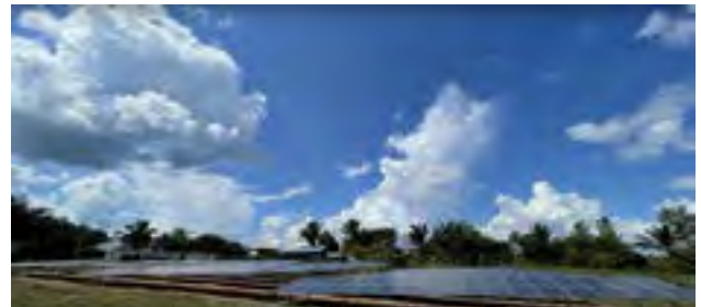
Sistema fotovoltaico de 250 kWp instalado no vilarejo. Foto: DEIF/Divulgação
