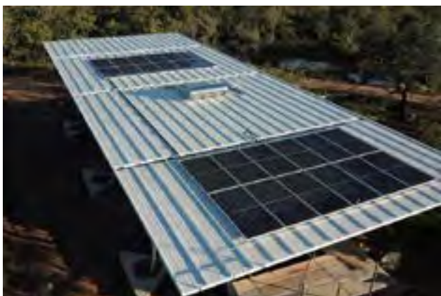
Módulos da BYD utilizados no projeto híbrido. Foto: Fonte Solar/Divulgação
