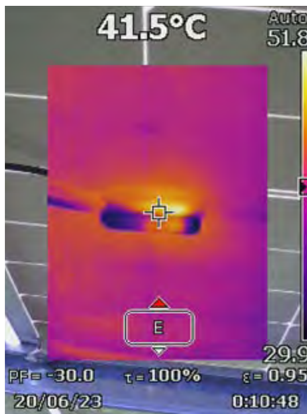
Figura 3: Termografia de um módulo com falha no diodo de bypass. Foto: Canal Solar
