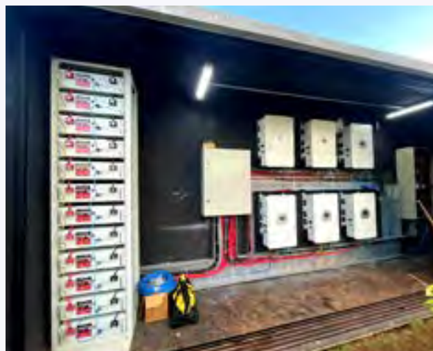
Sistemas com zero-grid com baterias instalados no estado de SP. Inversores e baterias Deye
