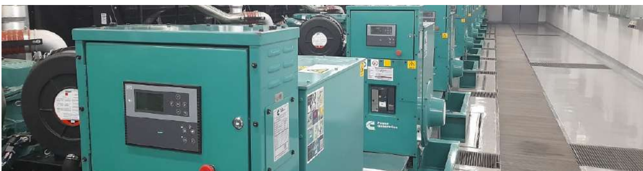
Geradores Diesel Cummins de 625 kVA com controladores AGC 150 DEIF integrados ao sistema híbrido. Imagem SSA/Divulgação
