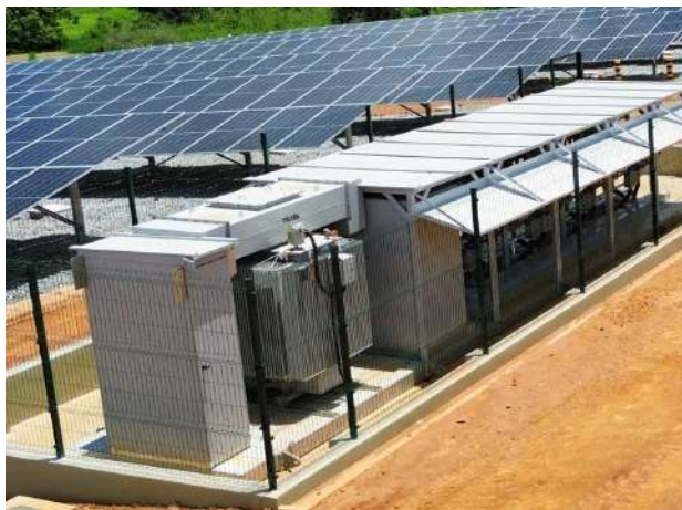
Skid da UFV: abrigo dos inversores, proteção BT e MT, transformação de 800 Vac para 13,8 kV. Imagem SSA/Divulgação
