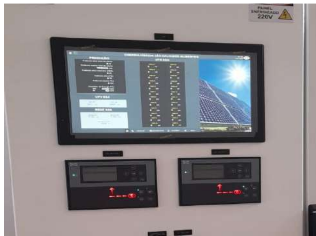
Painel com AGI421 (Tela Touch Screen 21" DEIF) para monitoramento e controle local e controladores AGC 150 Mains. Imagem: SSA/Divulgação
